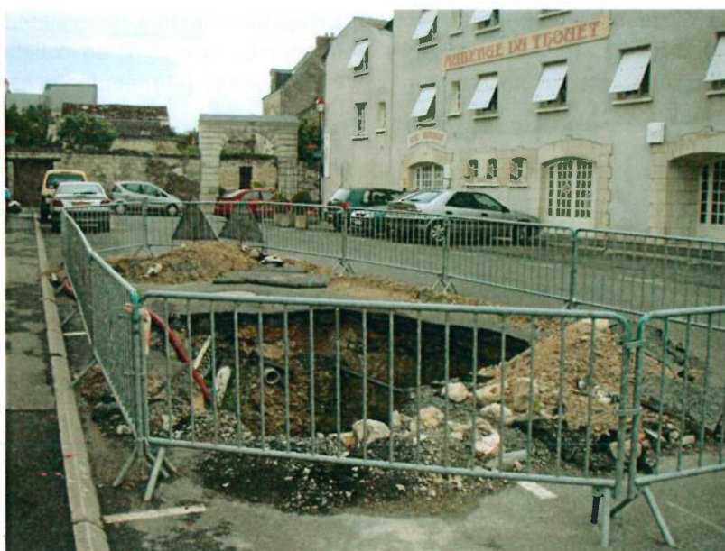
Photo : Effondrement de voirie à Chacé
